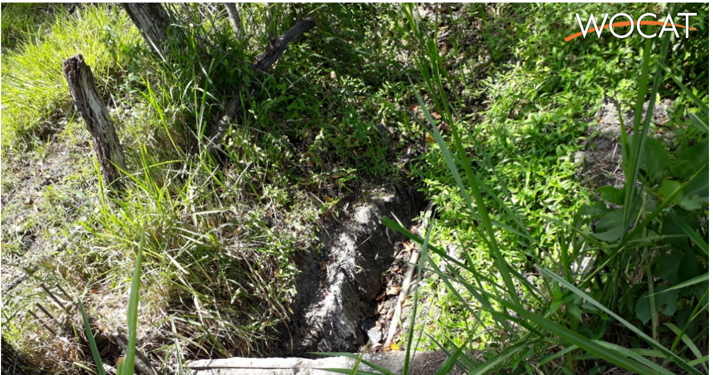
Muro de contención de agua, fotografía tomada en la Parroquia de Nambacola, Provincia Loja, Ecuador (FAO ECUADOR y Ministerio del Ambiente ECUADOR) Fotografías tomadas junto con el usuario de la tierra. (Luis Diaz, consultor DS-SLM ECUADOR)
